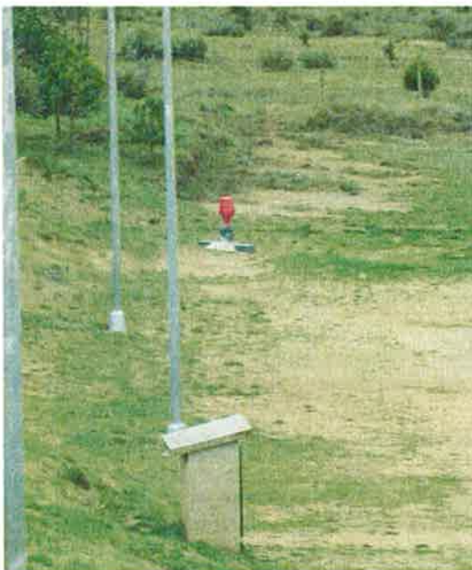
Figura 31. hidrant a l'interior del *Càmping Gironella*
